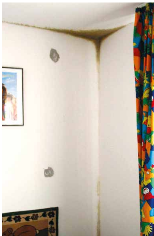
1. kép. Penészkár homlokzati falak és lapostető csatlakozásánál és vasbeton sarokpillér mentén
