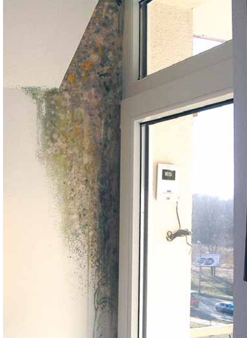
2. kép. A penészkárt a hőszigetetlen vasbeton erkélylemez hőhíd-hatása is növeli
