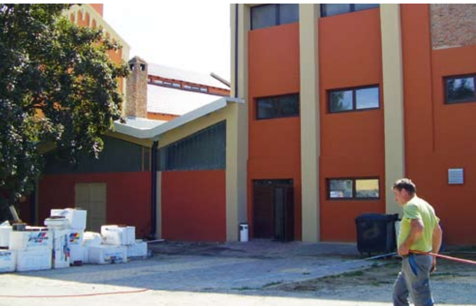
A gazdaságos működést az Austrotherm hőszigetelés is elősegíti.
